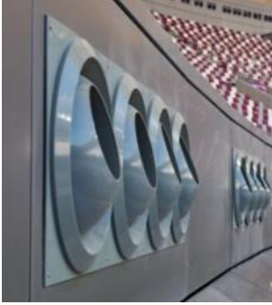
تجهيزات تبريد وتكييف البيئة الحارة ملعب قطر 2022
