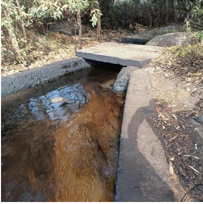
الشكل (3-3): مدخل محطة المعالجة
